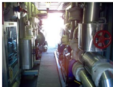
Inside recirculation module (Blabo I)
