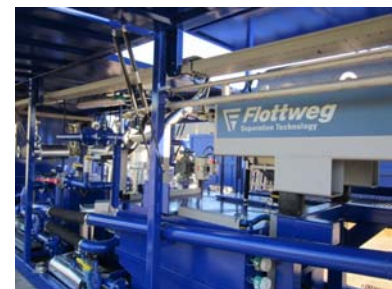
Inside separation module (Blabo II)
